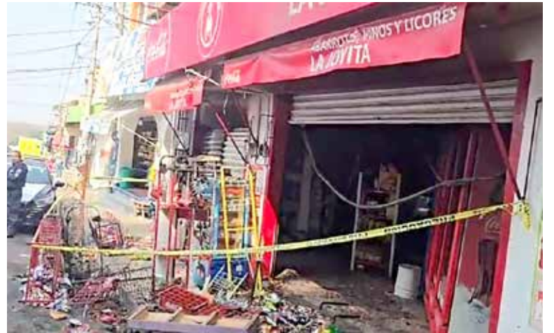
LA TIENDA RESULTÓ con diversos daños.
